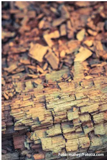
Fortgeschrittener Zerfall: Neben der Witterung sind hier verborgene Holzbewohner am Werk.
