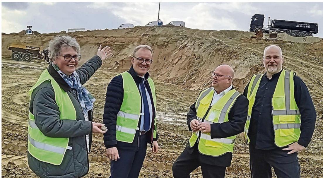
11,88 Meter tief: Bei der Baustellenbesichtigung mit (v.r.) Christian Busch, Uwe Lorenz und Landrat Volker Meyer zeigt Kreisrätin Ulrike Tammen (l.) den enormen Höhenunterschied.
